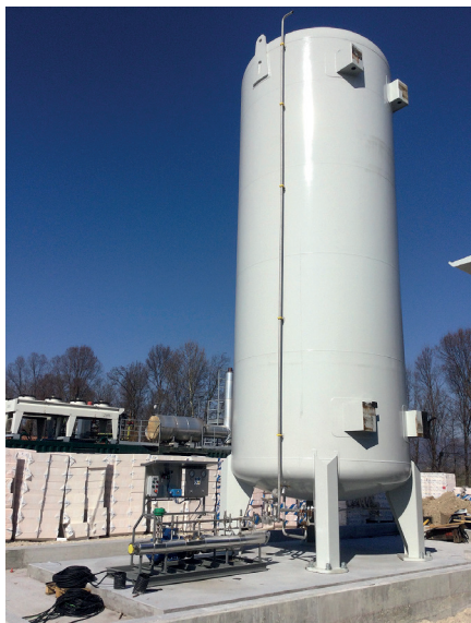
Abb. 22: Stationärer LNG-Speichertank mit Kreiselpumpe (© AB Energy Deutschland GmbH)
