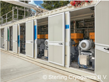
BioLNG Anlage in Hof, DE
