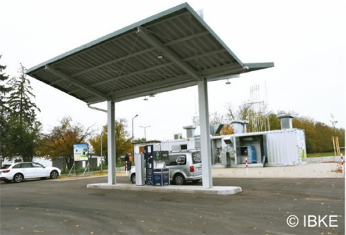
BioCNG Anlage in Frohndorf, DE
